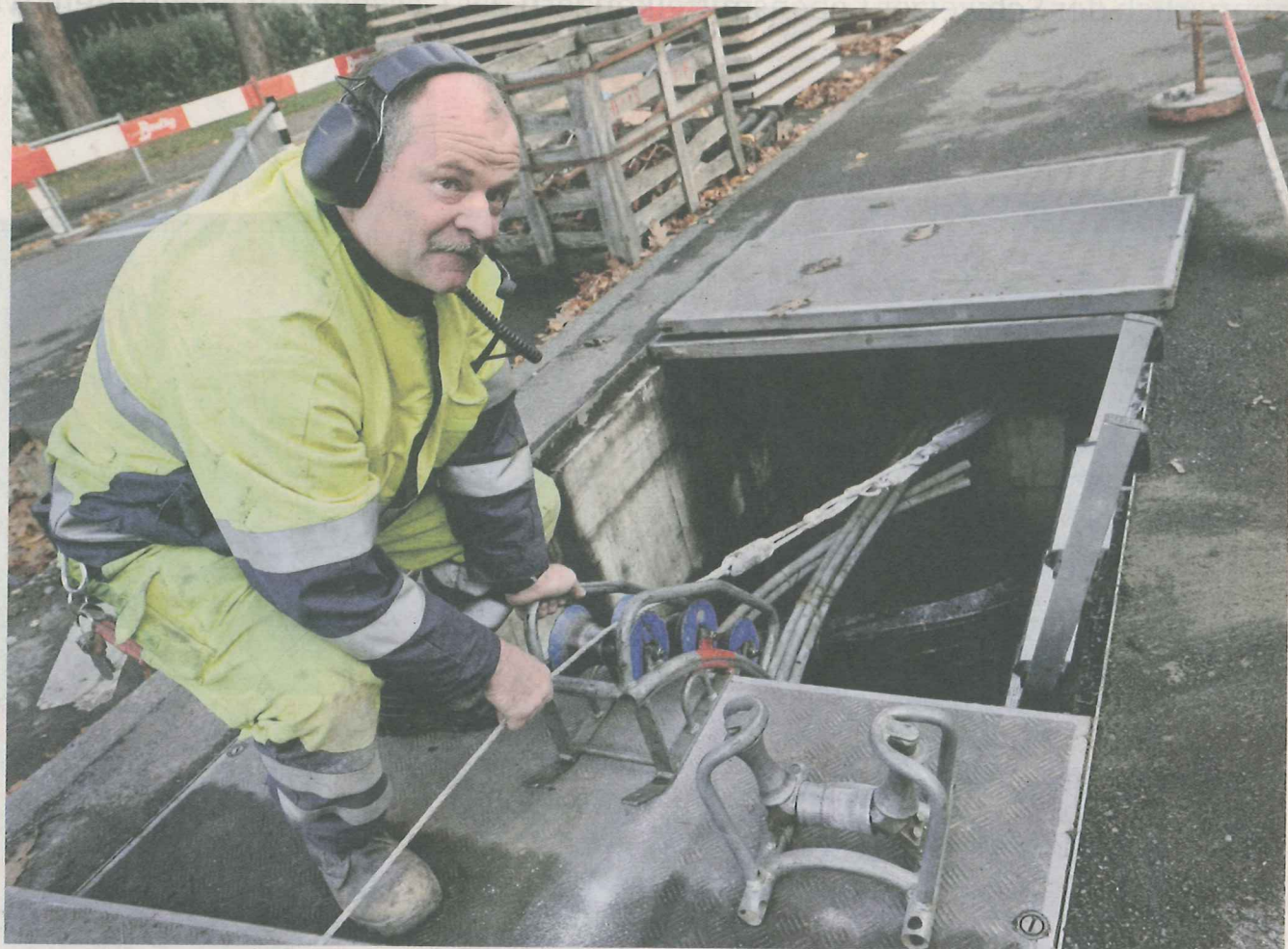
Ein Mitarbeiter von Energie Wasser Bern (EWB) verlegt ein Glasfaserkabel. Foto: Adrian Moser
